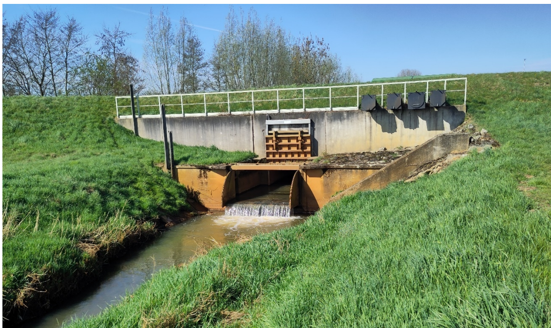
Figuur 7. Uitstroom dijkonderdoorgang Kwistbeek.
