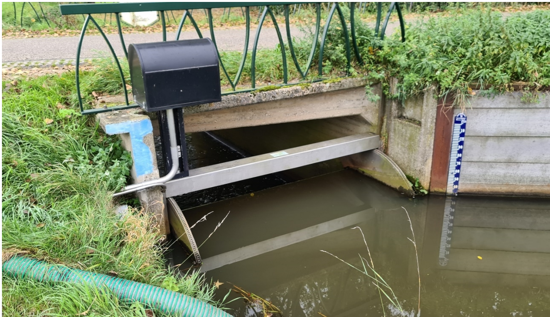
Figuur 6. De stuw bij de Ingweg
